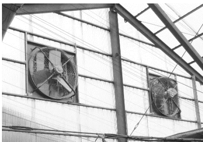
[ハウス換気設備 (頸城区)]
