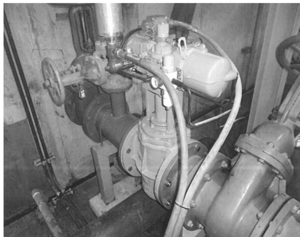
No.1-3 初沈汚泥引抜弁
