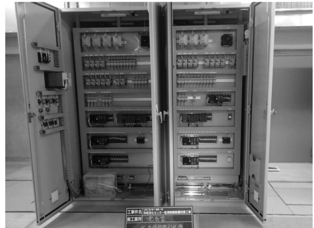
水処理・汚泥処理設備計装盤
