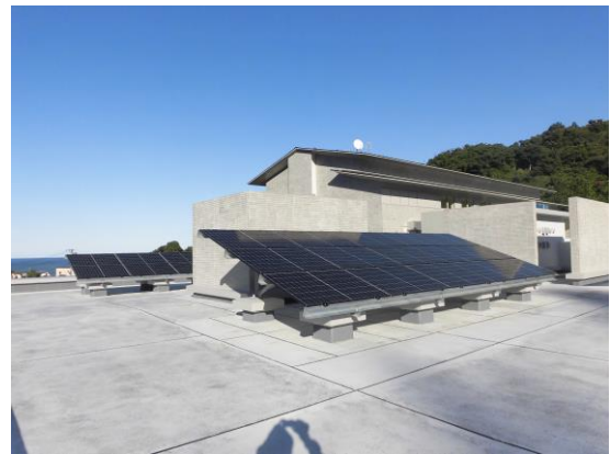
太陽光発電設備
