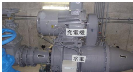
使用している発電機
