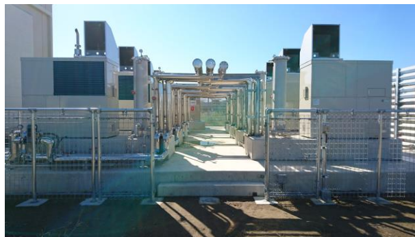
消化ガス発電施設
