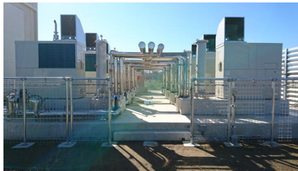
消化ガス発電施設
