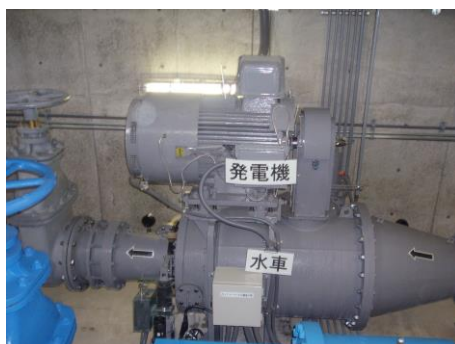
使用している発電機
