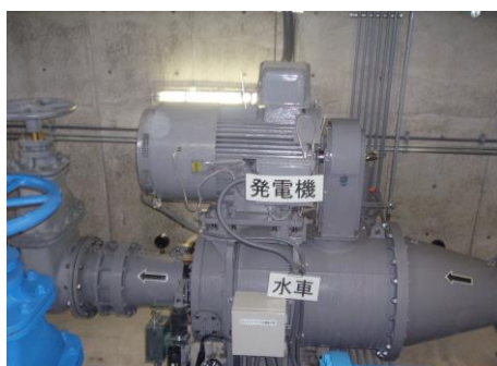
使用している発電機
