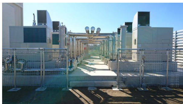
消化ガス発電施設
