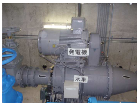
使用している発電機
