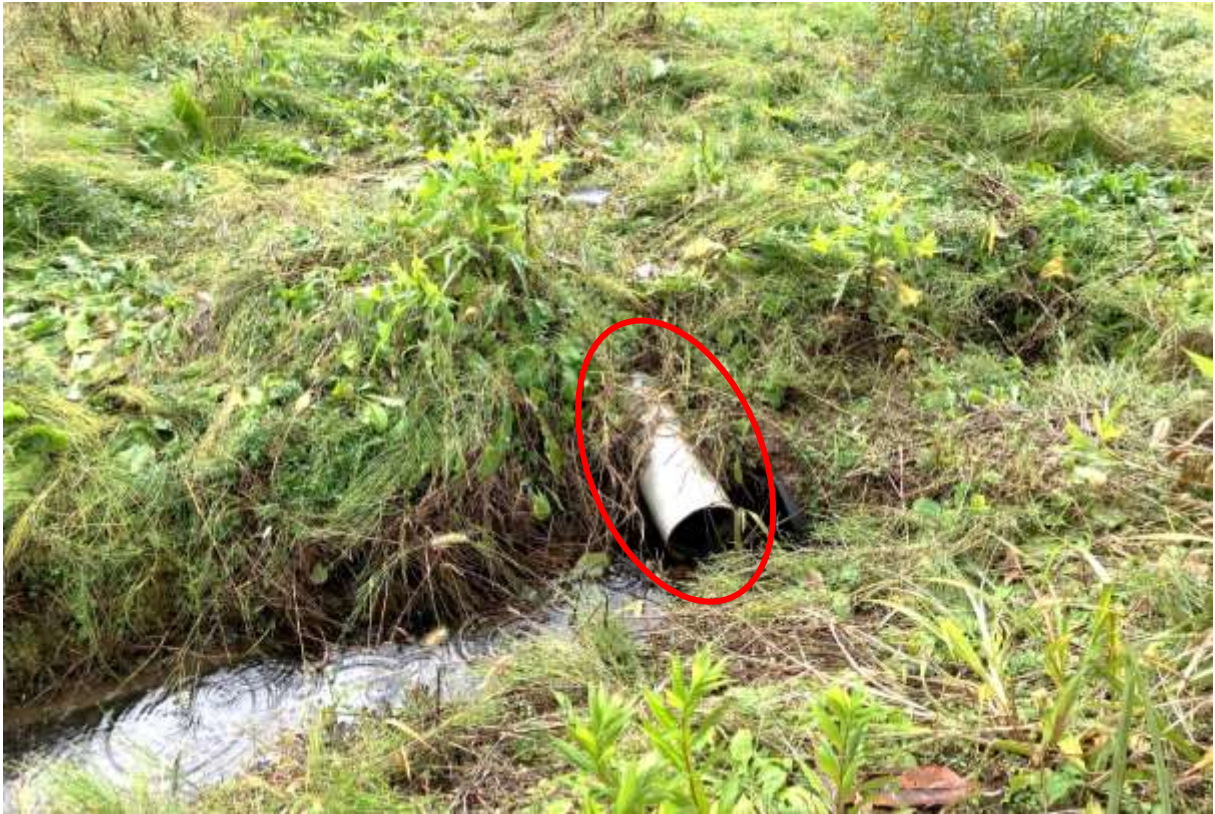
【残置物 埋設管（北側水路脇）】
