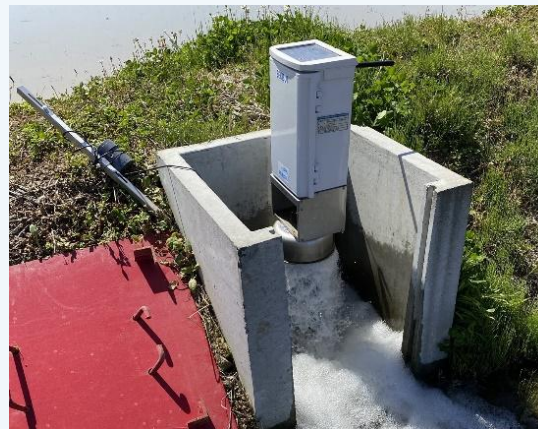
▲自動給水栓による給水
