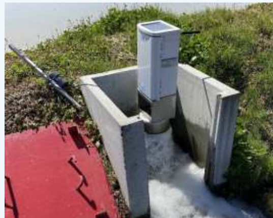
▲自動給水栓による給水
