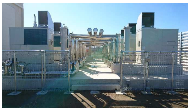
消化ガス発電施設
