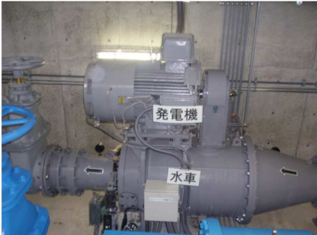
使用している発電機
