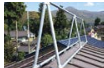
命綱固定アンカー設置例
