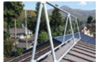
命綱固定アンカー設置例
