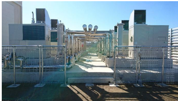
消化ガス発電施設
