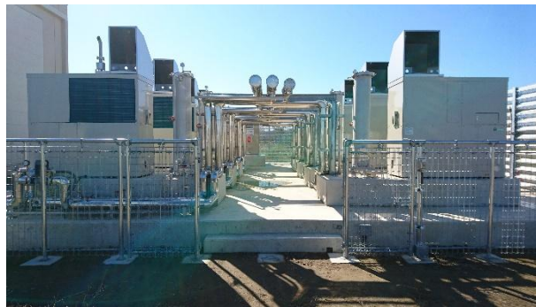
消化ガス発電施設
